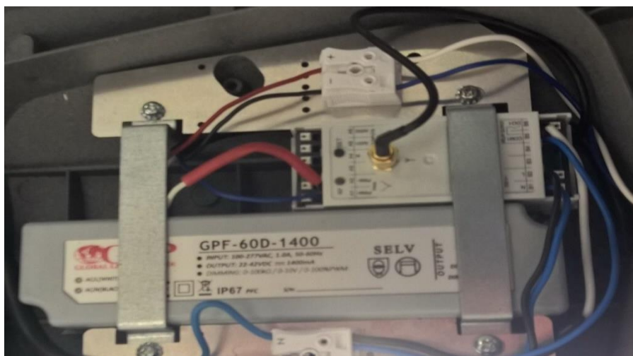
Obrázek 20 Elektrická výzbroj LED svítidla veřejného osvětlení, které je vybaveno regulovatelným driverem a přijímačem Wi-Fi. Volitelně lze vybavit senzorem přítomnosti nebo bezdrátovou kamerou včetně akumulátoru (foto: vlastní)
